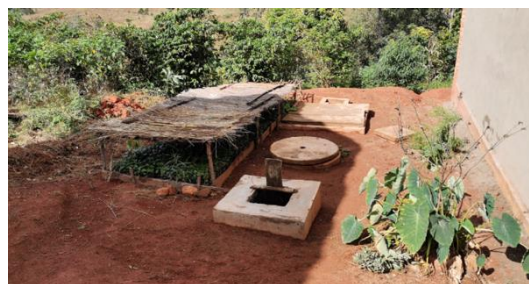
L'installation extérieure du biodigesteur enterré à côté d'une pépinière
