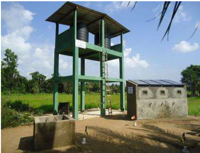
SRI LANKA : Château d'eau et pompe solaire ( province de Trincomalee)
