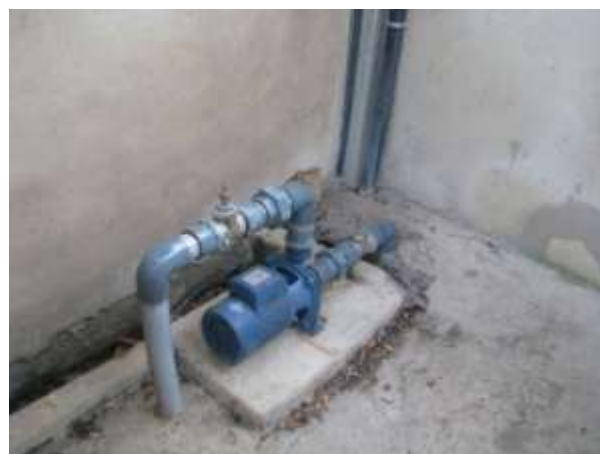
TOGO : Surpresseur pour le système d'adduction d'eau destiné à maraichage dans l'Institut National de Formation Agricole à Tové
