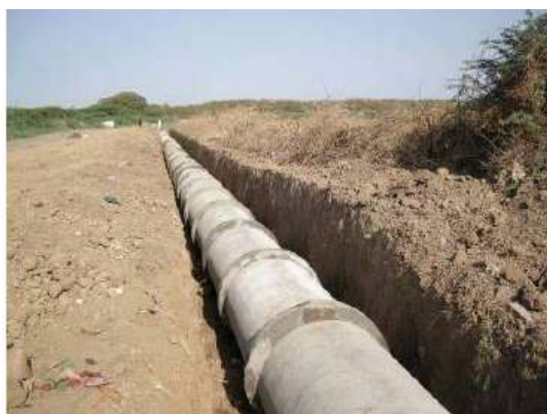
INDE : Pipe line de drainage à Luvara
